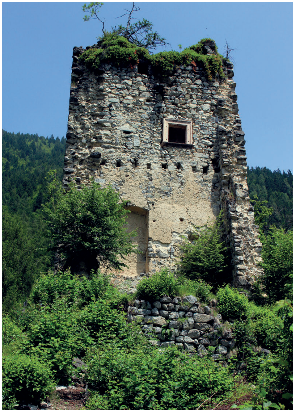
Una veduta della parte superstite del mastio. In alto la finestrella tamponata di gusto rinascimentale, e in basso, a sinistra, la grande nicchia ricavata nello spessore del muro settentrionale.
