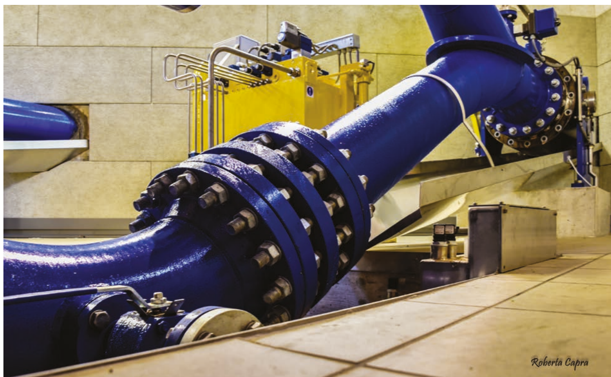
Un dettaglio dell'impianto di Masoenergia. Foto di Roberta Capra
