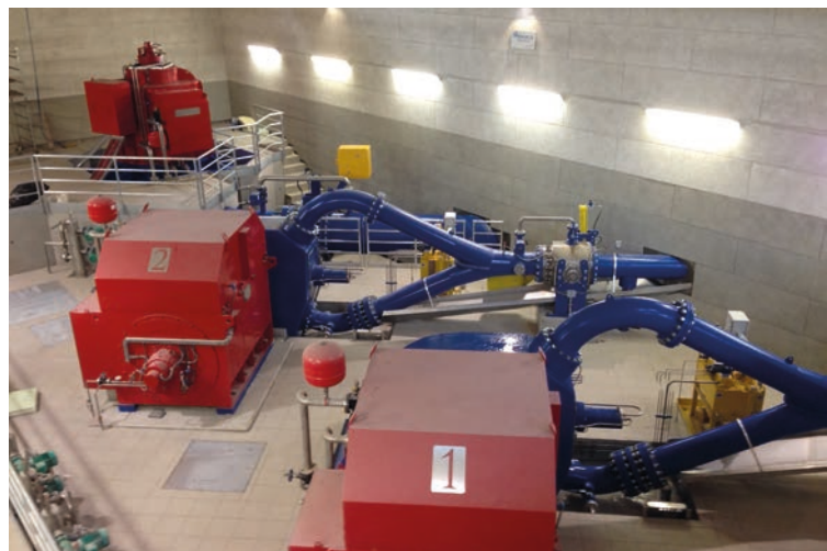
Sala macchine con le 3 turbine
