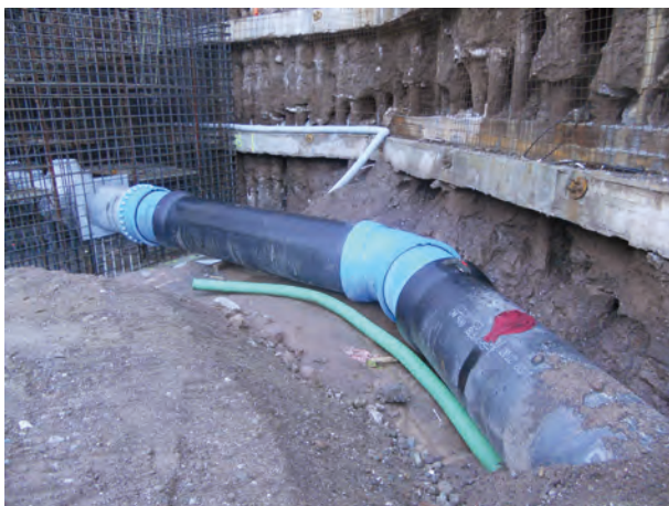
Presa Calamento - collegamento condotta con camera valvole
