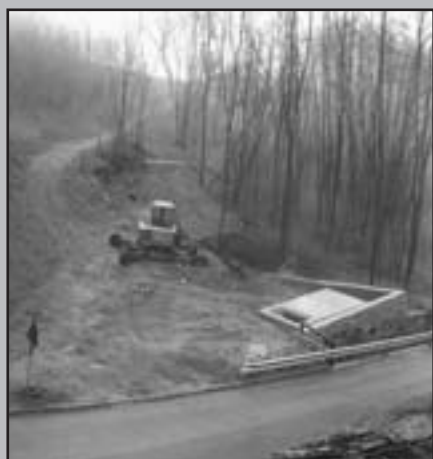
Fognatura intercomunale: vasca di dissipazione in località Ghisi
