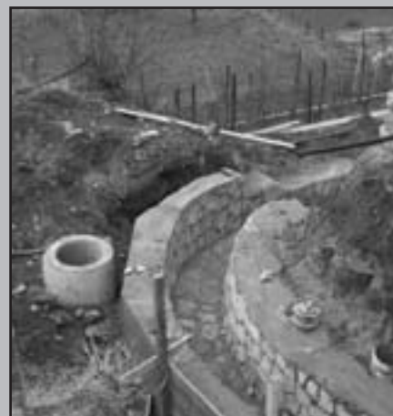
Fognatura intercomunale: tratto in canale in via Carzano
