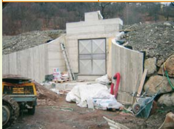
Nuovo serbatoio dell'acquedotto ai Cadenzi
