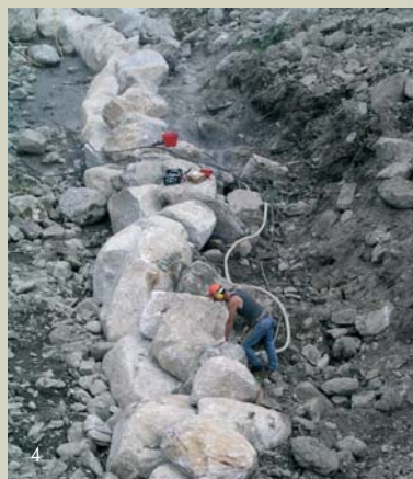
4 - Una fase dei lavori: la foratura dei massi. Successivamente nel foro sarà inserito un ancorante chimico e una barra filettata. Sulla barra sarà avvitato un golfaro attraverso cui passerà la fune d'acciaio. Nascono così circa 700 metri di scogliera.
