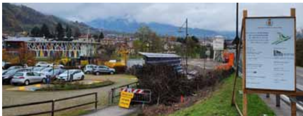
Sono quasi alla fine i lavori di preparazione degli accessi alla nuova struttura scolastica di via Temanza
