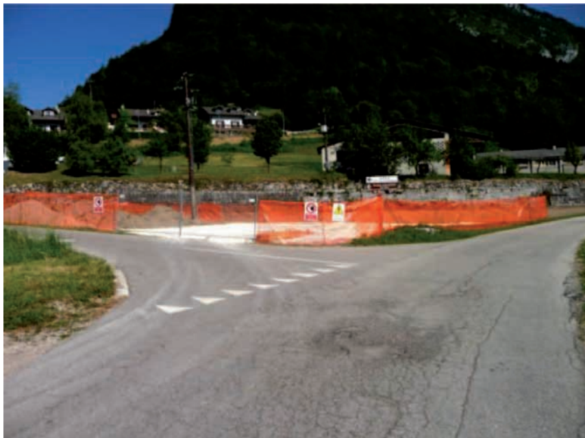
Area predisposta per il deposito del materiale di scavo in località Longana
