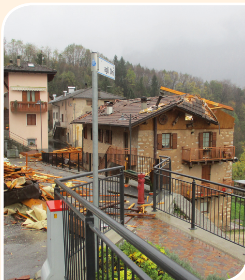
Danni del vento
