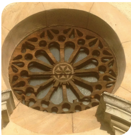
I danni del maltempo al rosone ligneo
