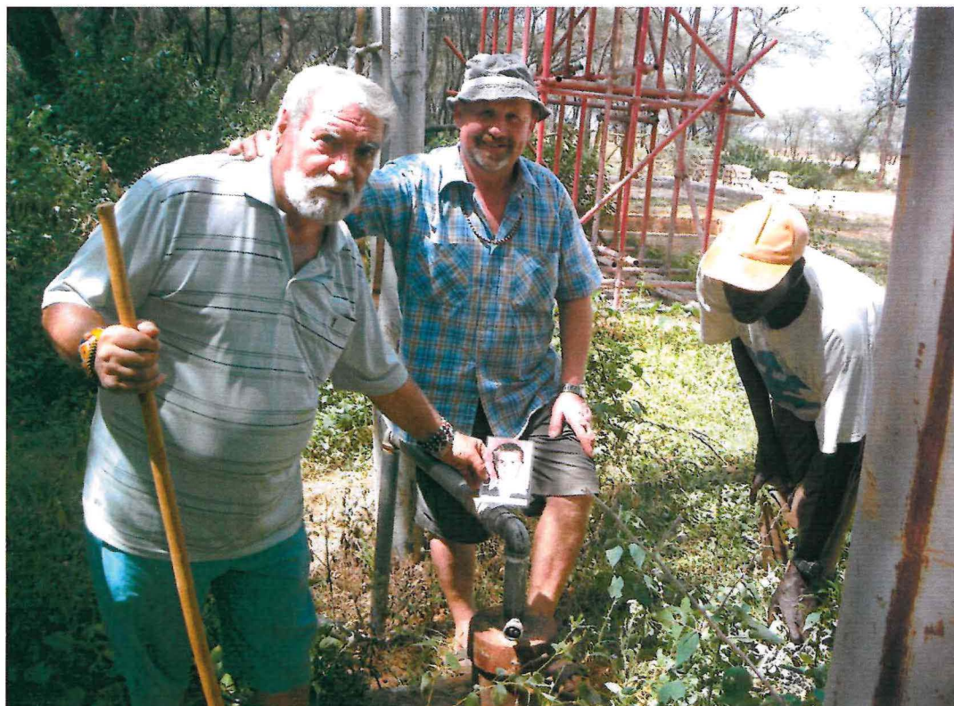
Padre Egidio Pedenzini (a sinistra) con Edy Martinelli vicino al pozzo in corso di realizzazione a Sereolipi
