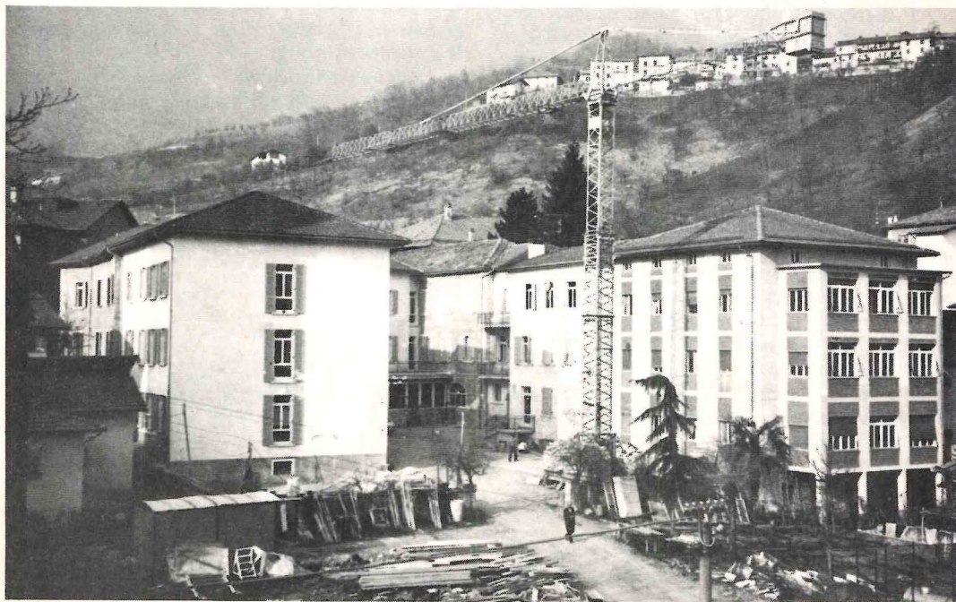
Strigno: la Casa di Riposo — I lavori di ristrutturazione volgono al termine!
