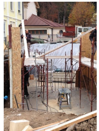
■ Proseguono i lavori per la realizzazione del sito che accoglierà la “bomba al cobalto”, di ritorno a Borgo
