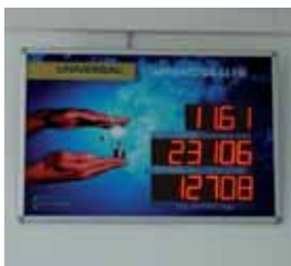
Il tabellone all'ingresso dell'Istituto che indica in tempo reale la produzione di energia prodotta dall'impianto fotovoltaico installato sul tetto dell'edificio di via Spagolla
