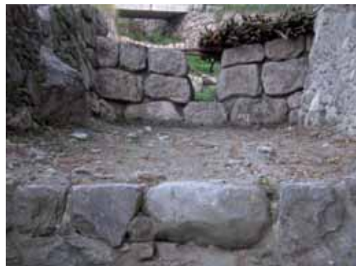
Il dettaglio di una serra lungo il Terzo Boale
