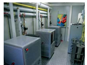
Tre cogeneratori, raccolti ad isola, per la produzione di energia elettrica ed energia termica
