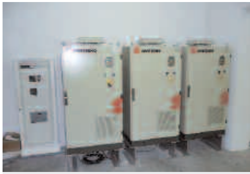
Gli inverter che consentono di trasformare e di valutare l'energia elettrica prodotta dall'impianto
