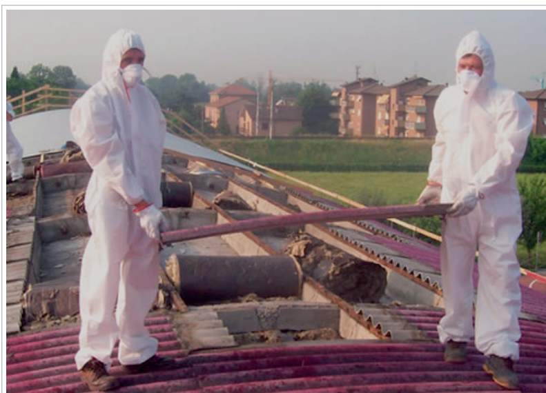
Operai specializzati al lavoro per eliminare una copertura in eternit. La protezione è fondamentale per evitare che chi lavora con materiali pericolosi di questo tipo possa subirne le gravi conseguenze, ormai accertate clinicamente, sulla salute
