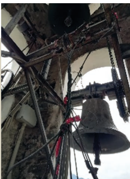
Il nuovo apparato meccanico del campanile
