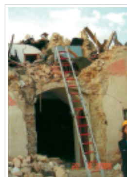
Un dettaglio dei danni provocati dal terremoto in Abruzzo
