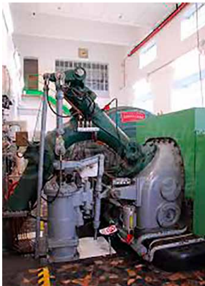
Centrale di Costabrunella
