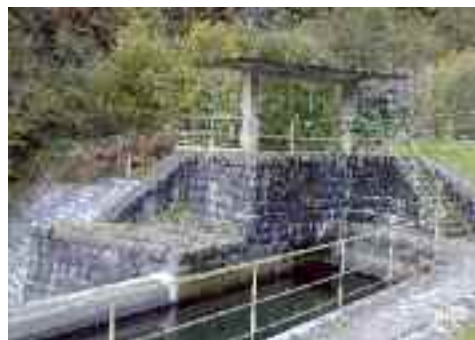
Dall'alto: il bacino di Pontarso; vista del Torrente Ceggio dal dissabbiatore
