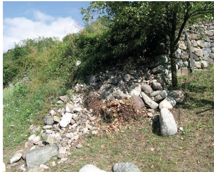
Il muro crollato nei pressi della scuola materna
