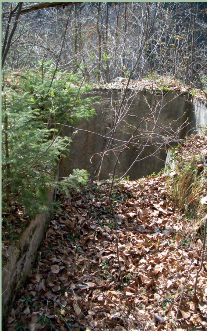
Vasca alla partenza della condotta forzata
