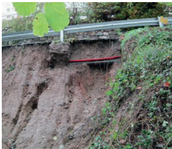
Frana Via Caverna
