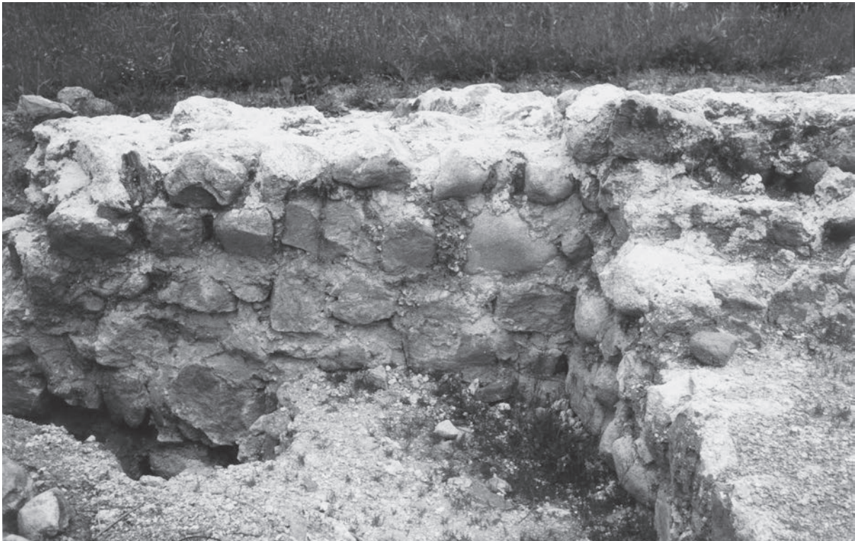
Lo stesso muro visto da sud. La legatura con calce viva (spenta in opera) delle pietre, secondo l'antico metodo, si presentava, dopo lo scavo (1993), ben conservata ed efficiente
