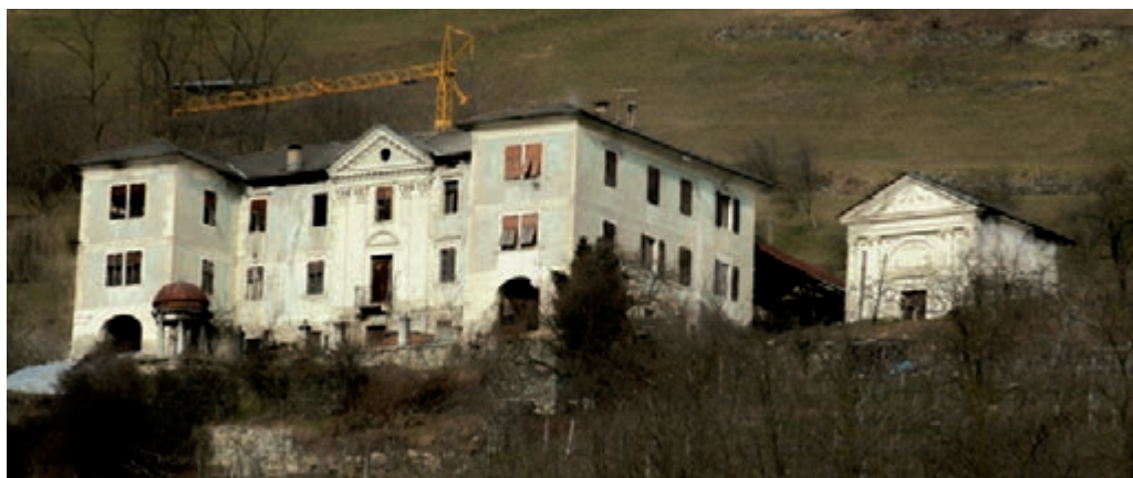
Il Maso Hoffer in fase di restauro. Notare il glorietto in primo piano e, a destra, la cappella di San Luca, eretta nel 1829.
