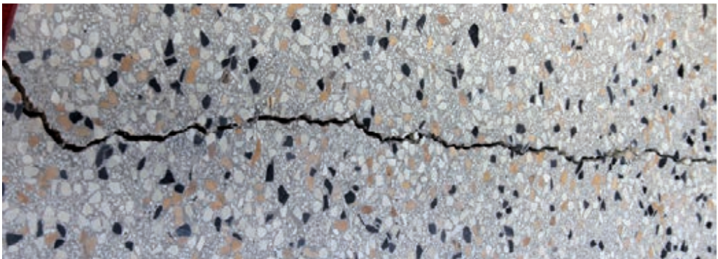
La larga crepa sulla palladiana che taglia in due il pavimento della navata in prossimità dell'arco santo.
