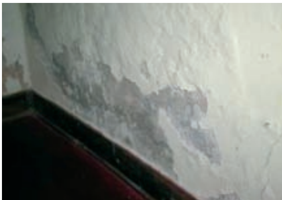
Caduta dell'intonaco nel presbiterio
