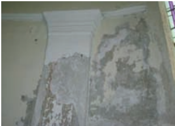
Disgregazione dell'intonaco nell'abside
